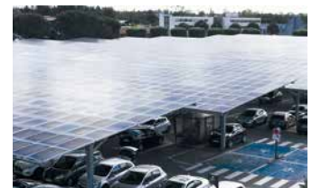
Ombrières de parking installées sur un centre commercial à Montauban. La production annuelle du projet atteint environ 3 000 MWh par an.
